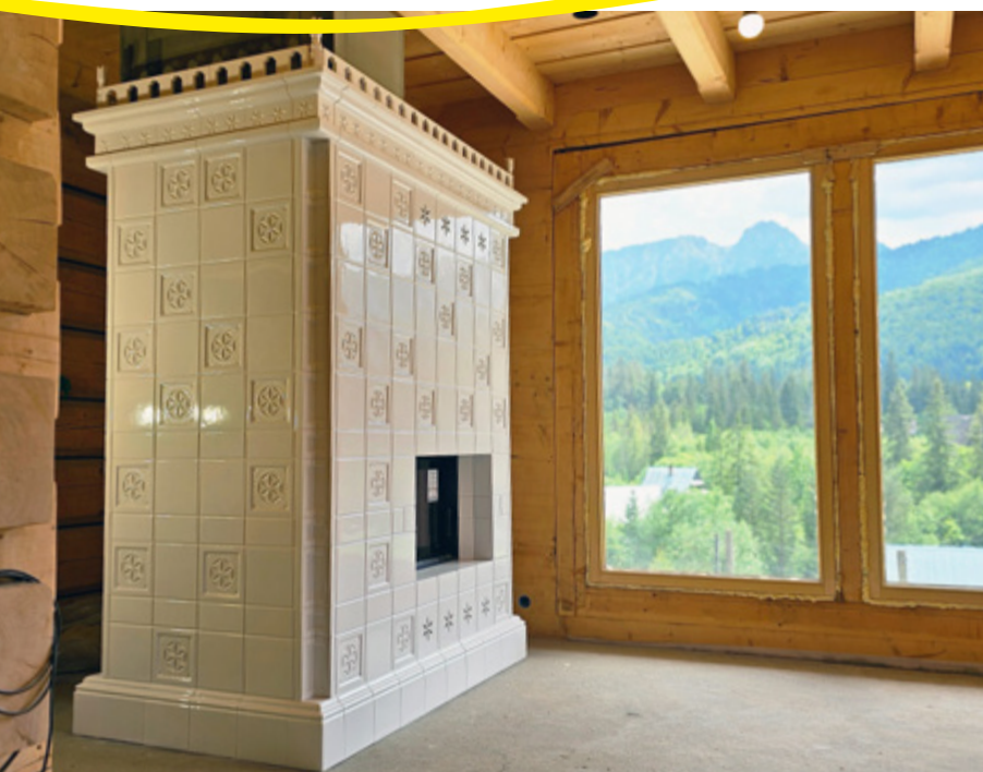
REALIZACJA KOMINKI Z KAFLI A.DZIADKOWIEC, PALENISKO DEFRO HOME, KAFLA KAFLARNIA KAFEL-ART
